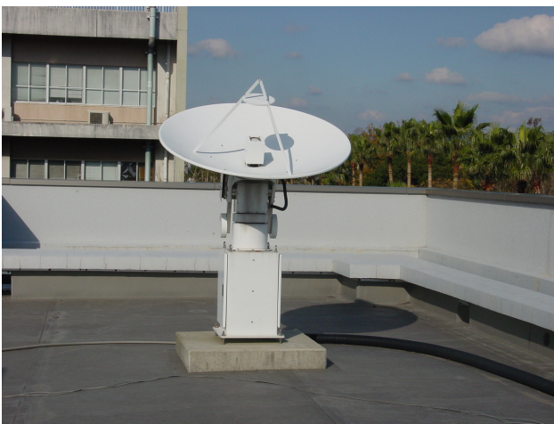
図1：実験で使用しているアンテナ
